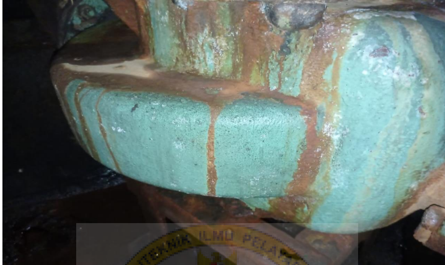
Kerusakan pada pondasi pompa yang menyebabkan awal mula kerusakan pada pompa main cooling sea water
