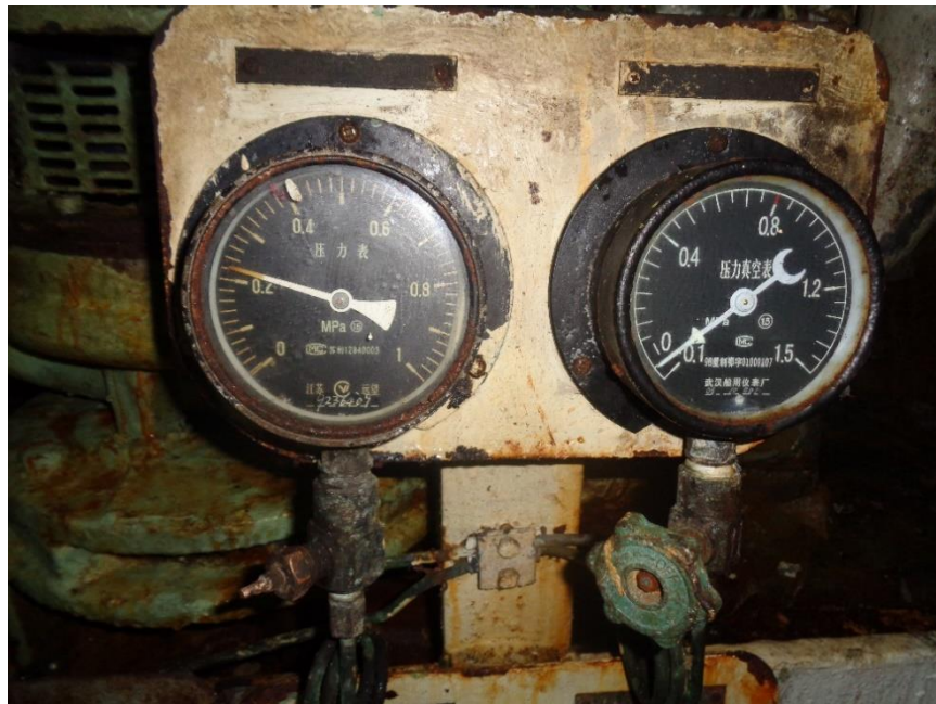
Dokumentasi Foto Tekanan Pompa yang Rendah.
