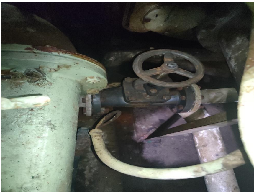
Setelah dilakukan pergantian Suction valve
