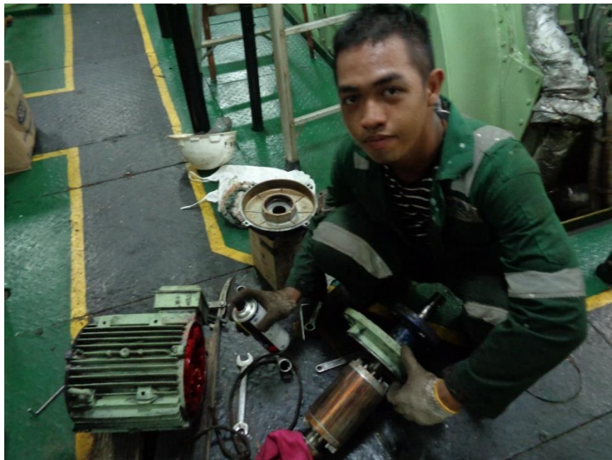
Dokumentasi Foto saat Overhaull Pompa Ejektor
