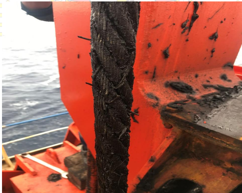
Wire Rope yang Rusak Saat Digunakan Bongkar Muat
