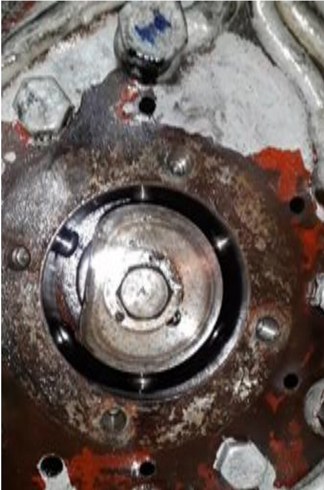
Katub Air distributor valve yang macet
