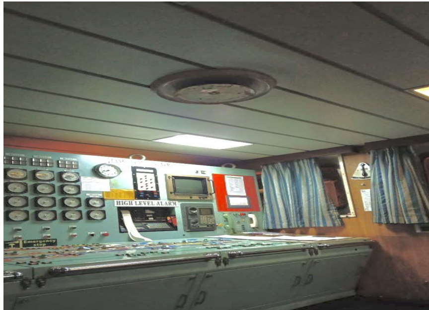
Gambar 2.3 Cargo Control room Sumber: Dokumentasi pribadi
