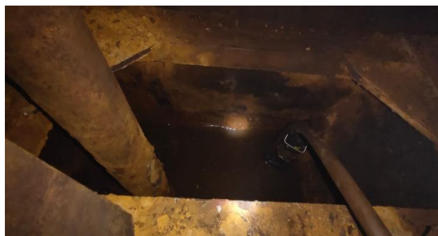
Gambar 4.5 Sumbatan di jalur pipa sounding
