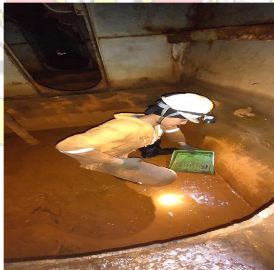
Gambar 4.4 Kebocoran dari WBT 5 ke tangki void 4 kanan
