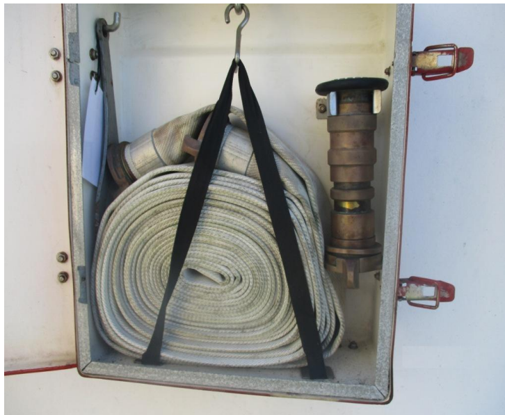
Gambar 2.7 Fire Hose Sumber : Dokumentasi MT. B ACE (2021)
