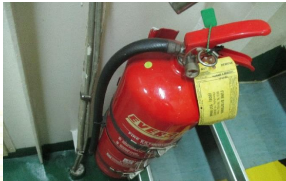
Gambar 2.4 Portable Fire Extinguisher Sumber : Dokumentasi MT. B ACE (2021)
