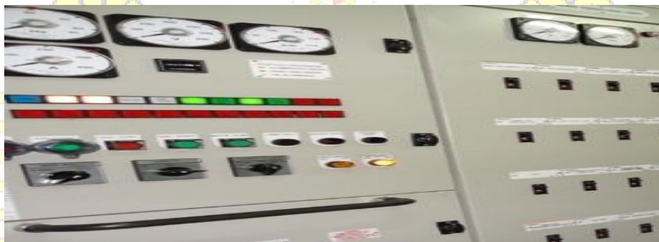
Panel pada Main Air Compressor
