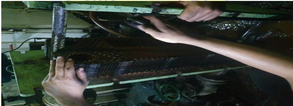
Kondisi Cooler Plate
