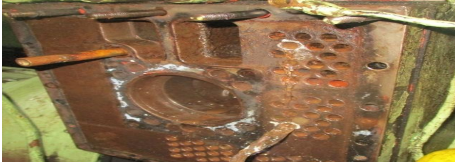
Kerusakan Pada Pipa Intercooler Main Air compressor Sumber : Dokumentasi MV. SKY SUNSHINE (2020)
