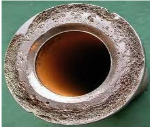
Gambar 2. 5 Korosi celah pada sambungan pipa
