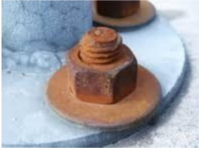
Gambar 2.3 Korosi galvanik pada baut
