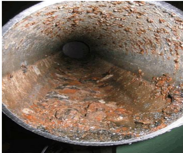
Gambar 2.6 Korosi celah pada Sumuran
