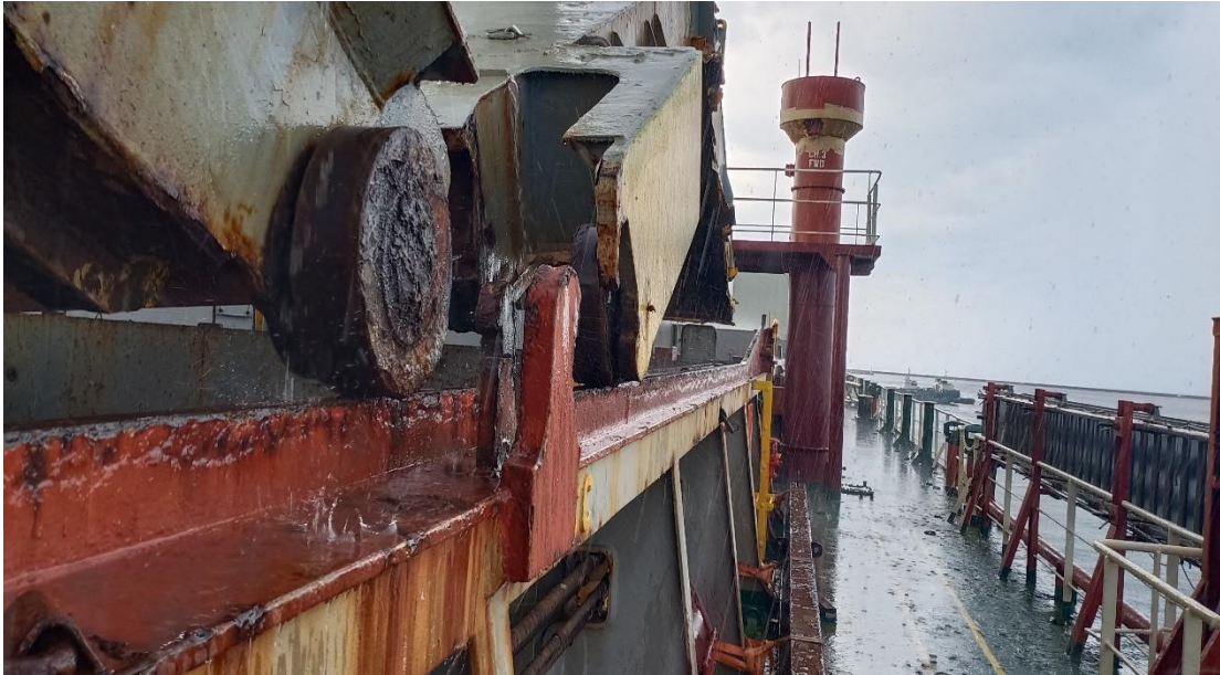
Lampiran 5. Kondisi palka akibat karat
