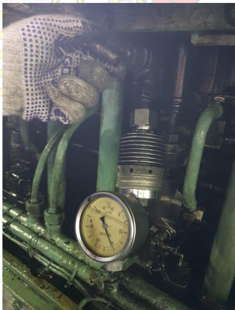
Pengecekan Pmax diesel generator
