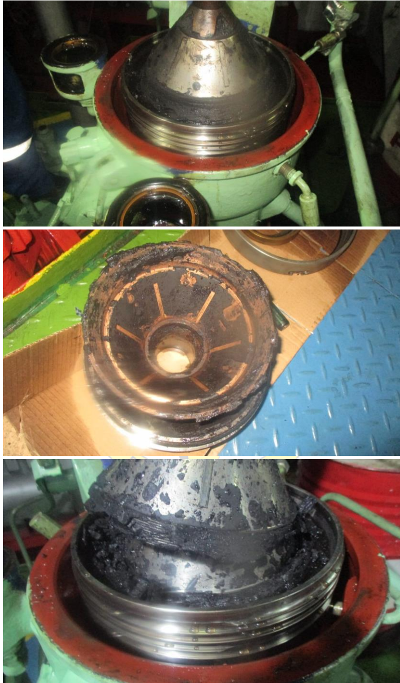
Keadaan Purifier yang kotor
