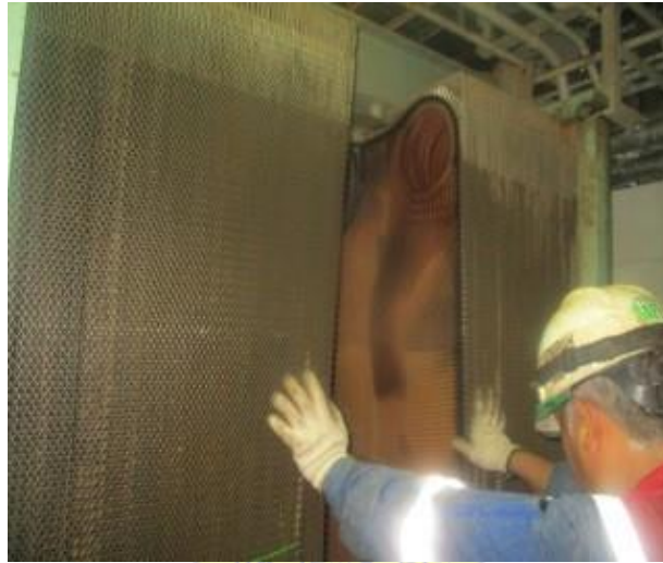
Kondisi Cooler Plate
