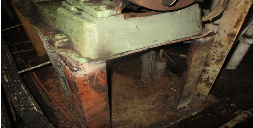
Kerusakan Pada pondasi pompa yang menyebabkan awalmula getaran pada pompa feed water pump
