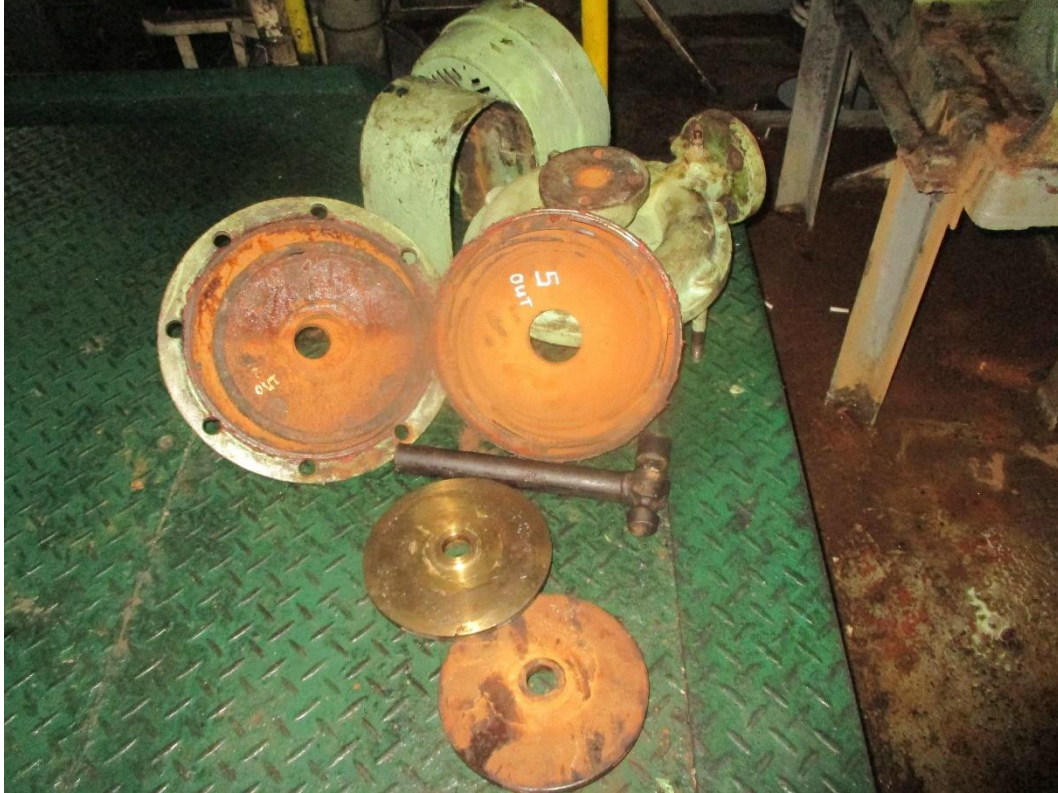
Kondisi komponen di dalam pompa feed water pump
