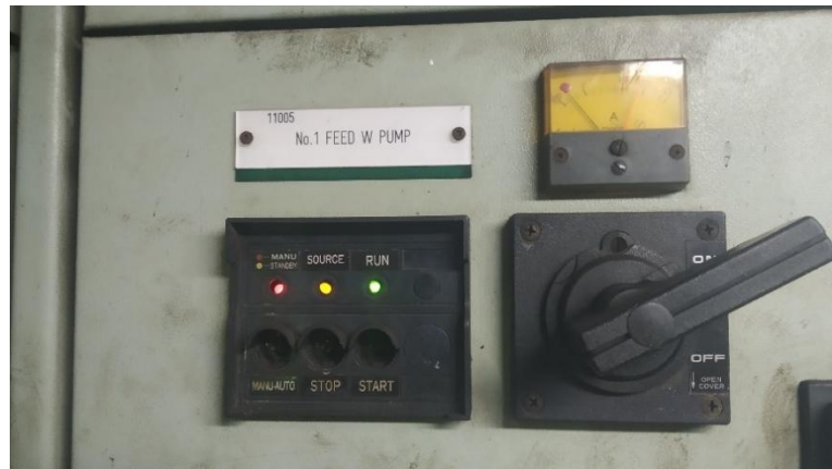
Ampere dari feed water pump no 1 yang melebihi normal
