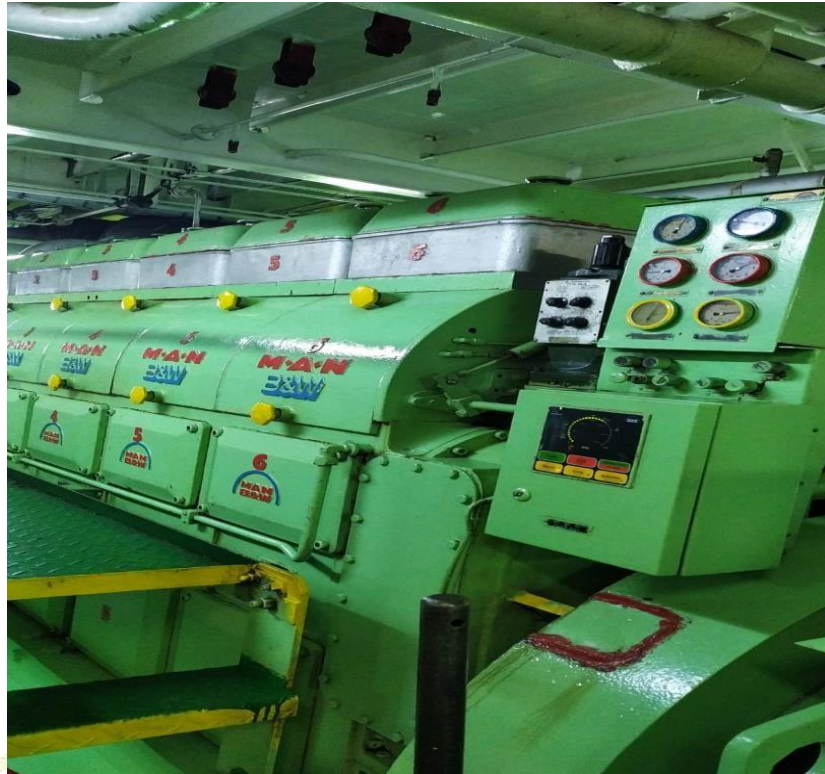
Gambar 2.2 Mesin Hyundai MAN B&W Diesel Generator Sumber: Dokumen Pribadi MV. Sinar Sabang
