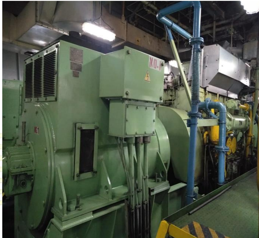
Gambar 2.6 Diesel generator di MV. Manalagi Samba.
