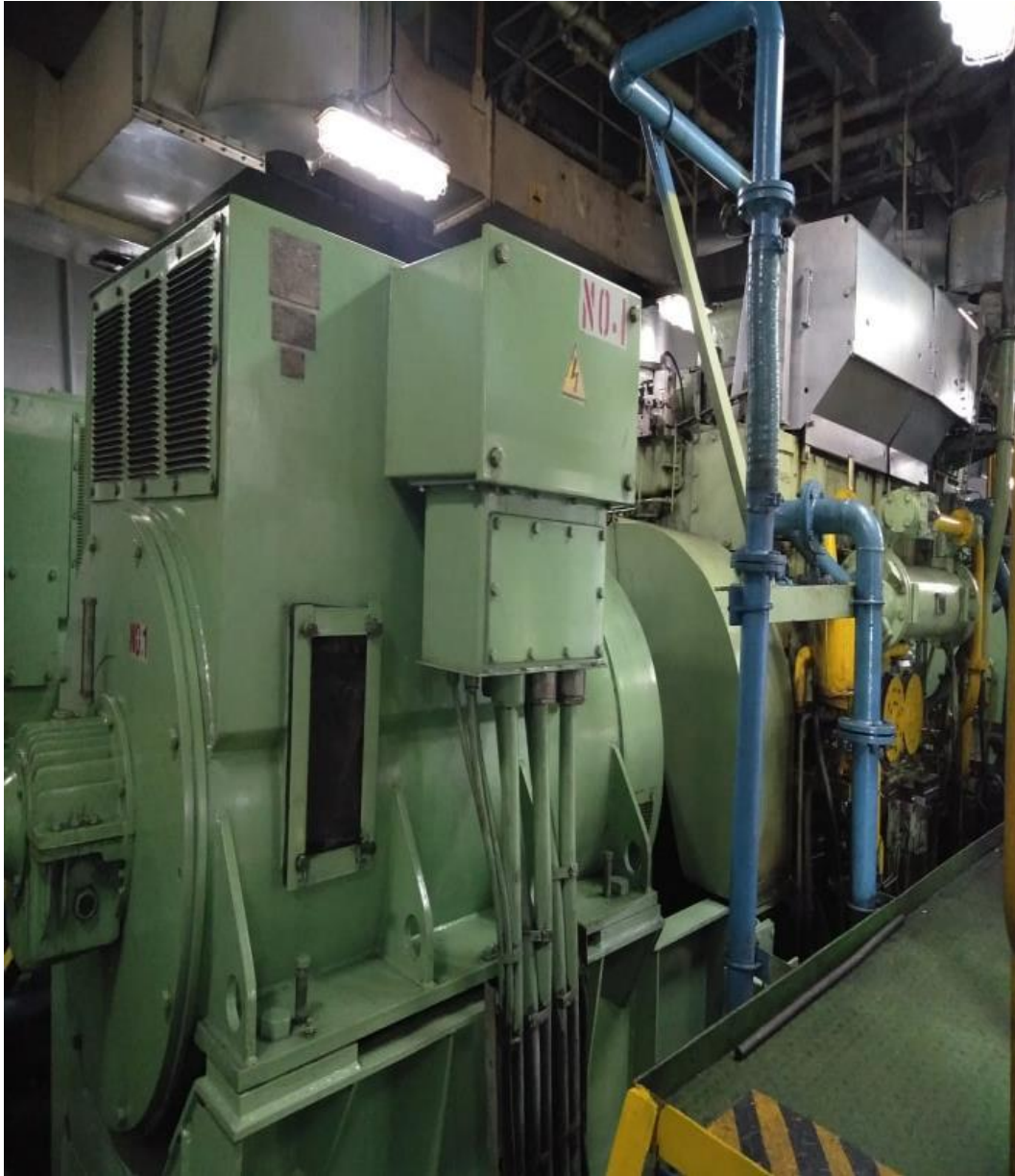
Gambar Mesin Diesel Generator di kapal MV.Manalagi Samba
