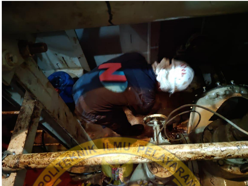
Gambar 3. Crew membersihkan minyak di bawah pipa dalam pump room
