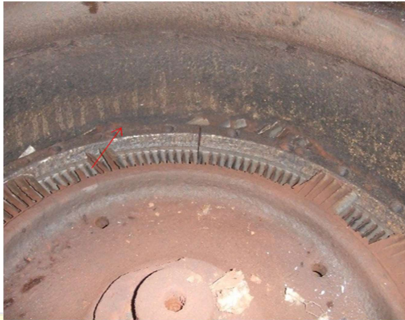
Lampiran 4. Rusaknya Sudu Jalan
