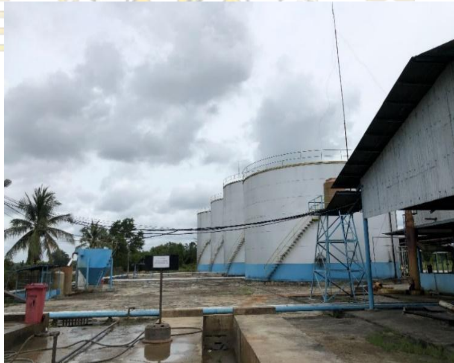
Gambar 2.2 Shore Tank Teluk Bagus
