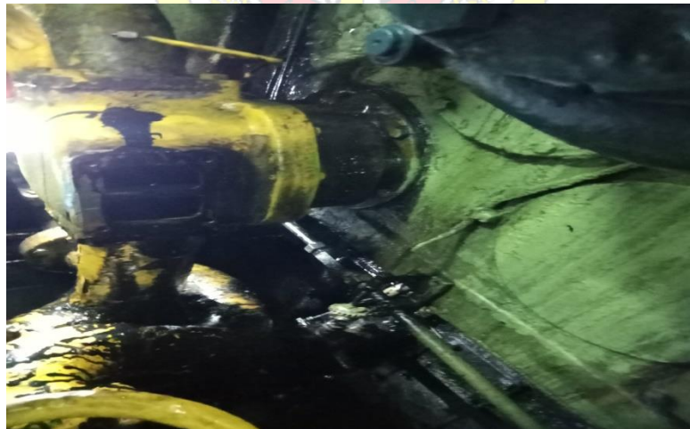
Kerusakan pada packing pompa oli Sumber : Dokumentasi MV. Armada Serasi (2020)
