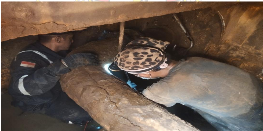
Kondisi pipa ballast
