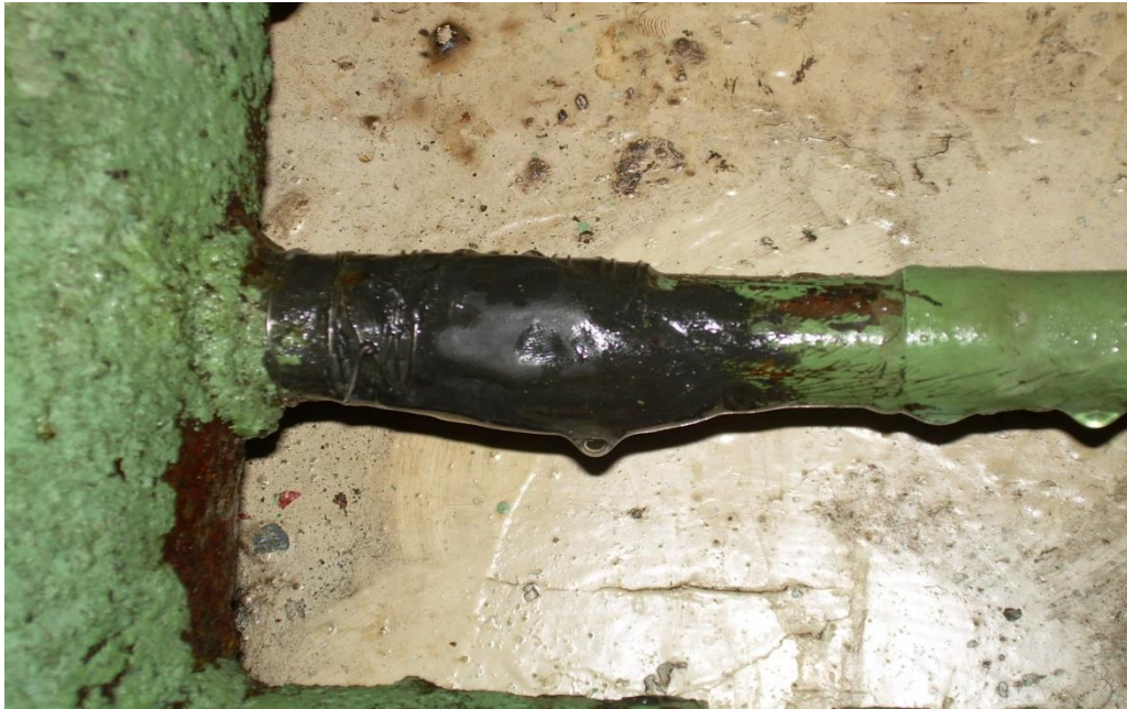
Gambar kebocoran paaa Sambungan Pipa Pada System
