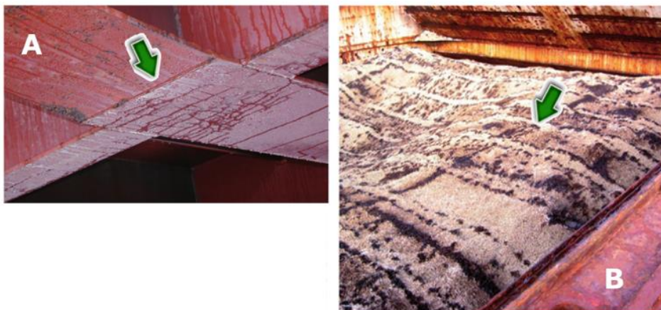
Gambar 3.27. Keringat kapal yang merusak muatan.
