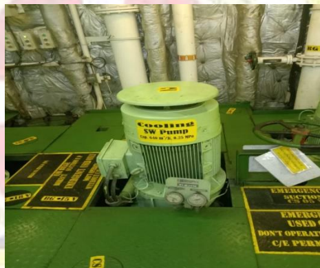
Gambar 2.7 pompa air laut
