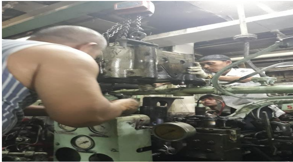
Lampiran 1.3 Bekerja tidak menggunakan alat pelindung diri
