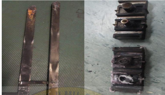
1. Gambar busbar dan isolasi yang terkena ledakan.
