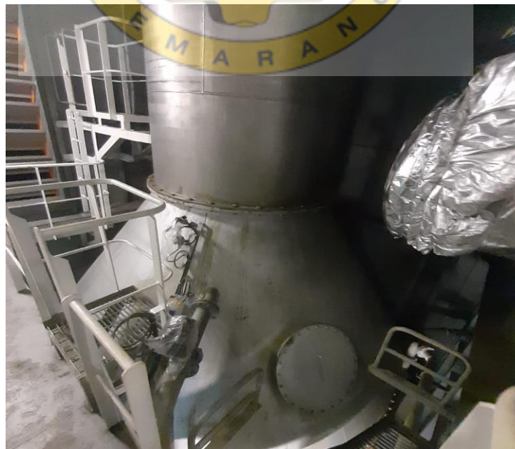
Puncak absorber pada sistem scrubber
