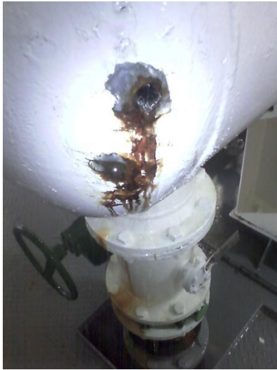
Gambar 4.2 Shell tube condenser yang mengalami kebocoran karena karat
