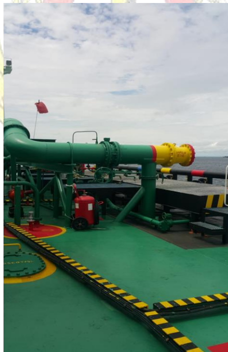
Sumber: Dokumentasi (2019) Gambar APAR (Alat Pemadam Api Ringan) di dekat manifold kiri
