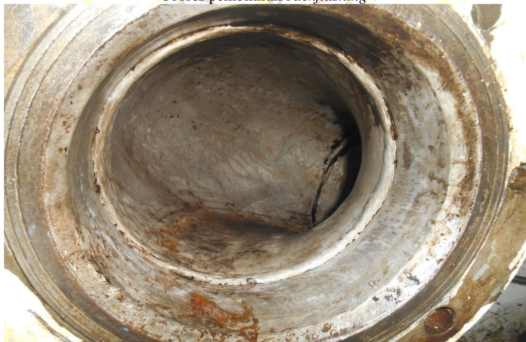
Pipa cooler setelah disirkulasi
