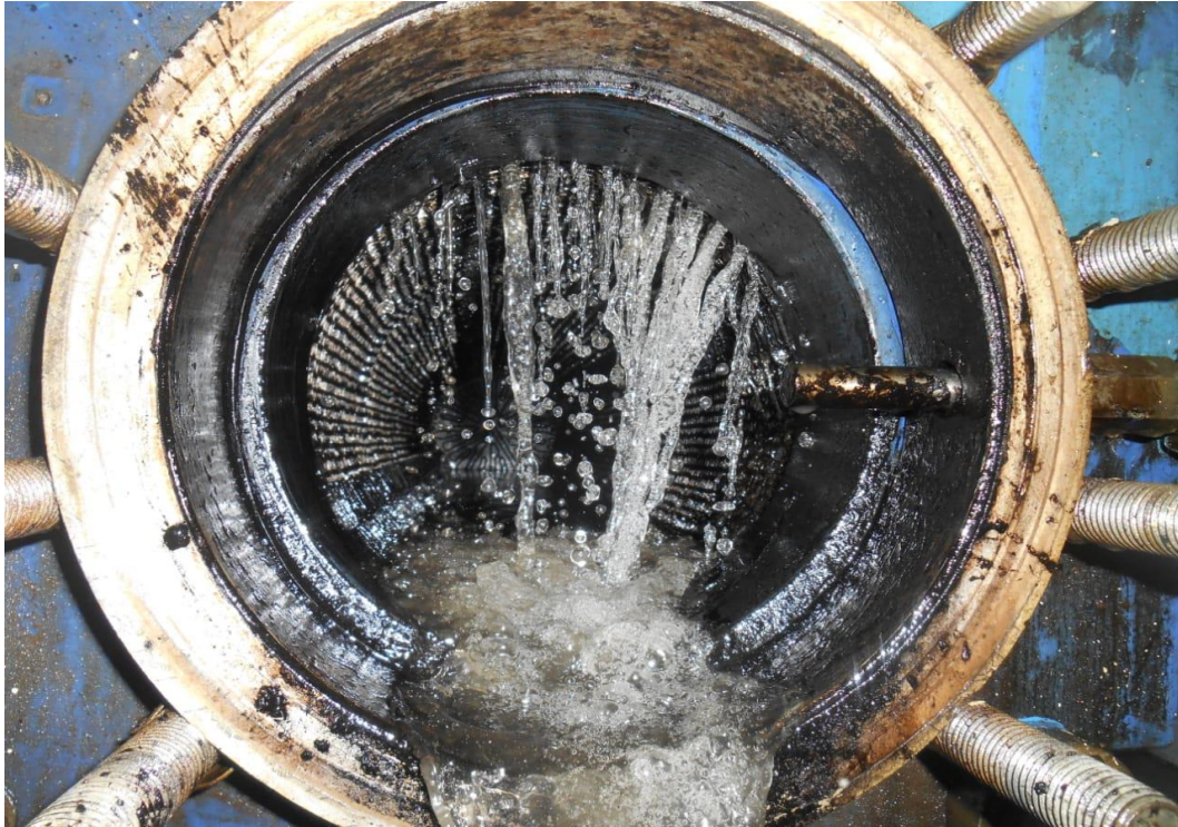
Proses pembilasan/ backflushing
