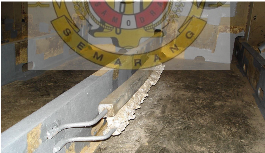
Gambar: Zinc Anode Pada Tangki Ballast
