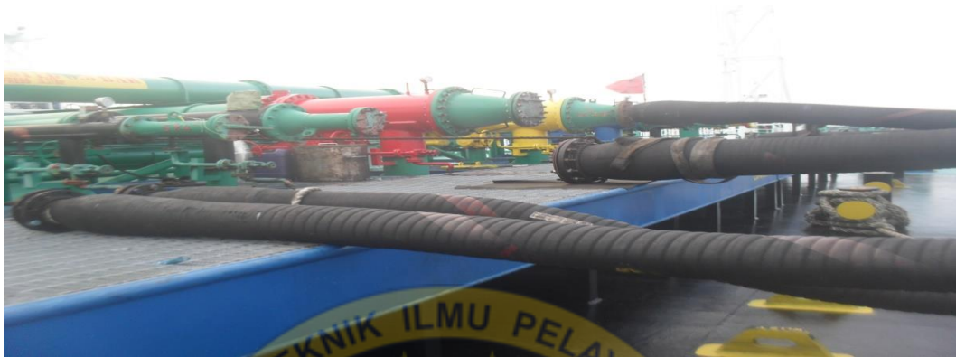
Tidak adanya fire hose di manifold
