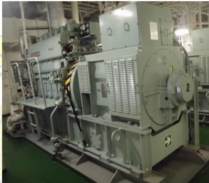
Gambar 2.1 Diesel Generator di MV. Navios Coral.
