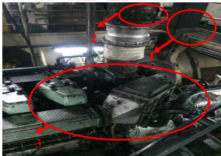
Gambar 4.5. Ruang kamar mesin yang kotor
