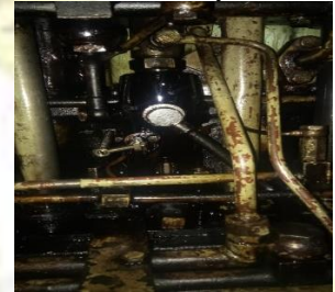
Sumber. Dokumen pribadi Gambar 4.5 kebocoran pada delivery valve
