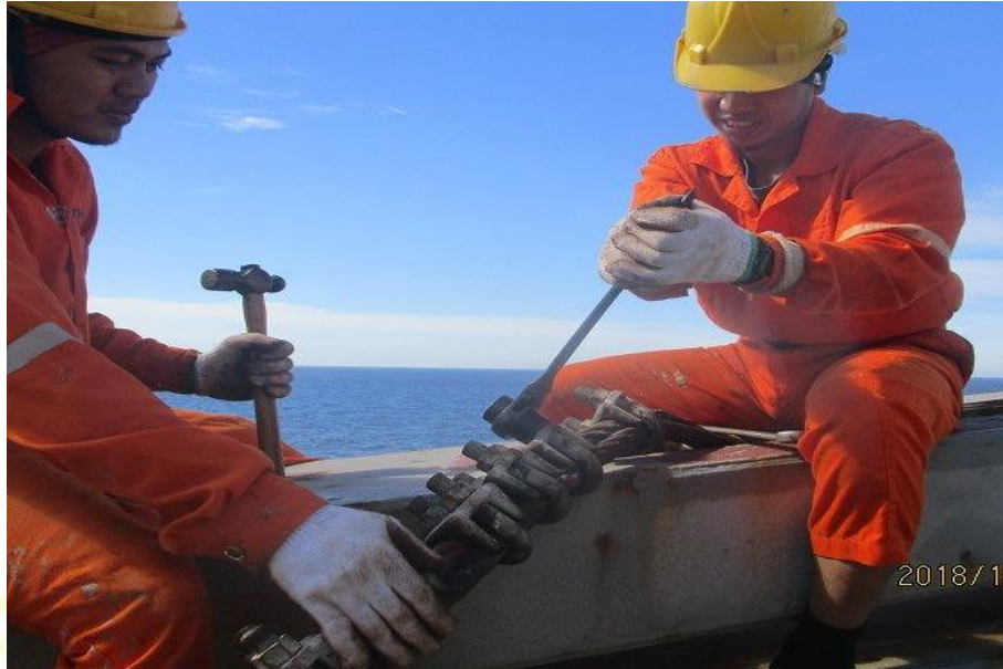
Gambar 1. Perawatan pada Collapsible Stanchion
