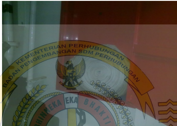
Gambar 2.1: Nozzle jet dan selang yang terdapat di hose box
