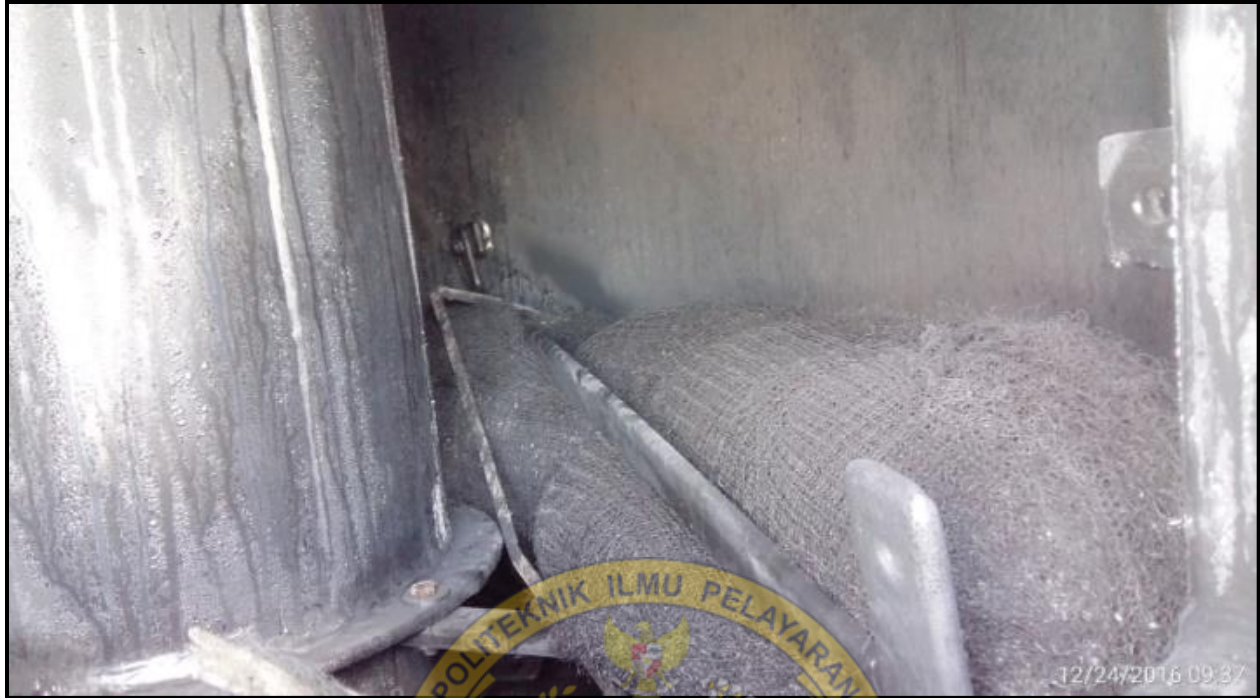
Lampiran 6.1 Gambar kerusakan pada demister karena kurang perawatan
