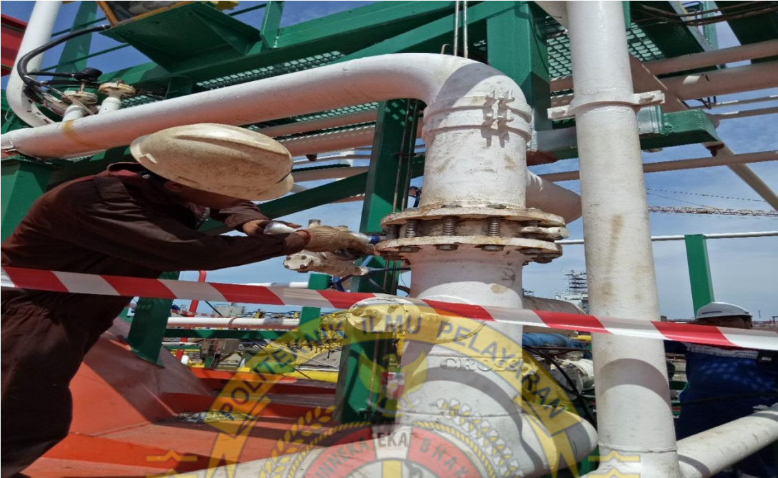
GAMBAR KONDISI PENGENCANGAN BOUT DI SEKITAR MANIFOLD
