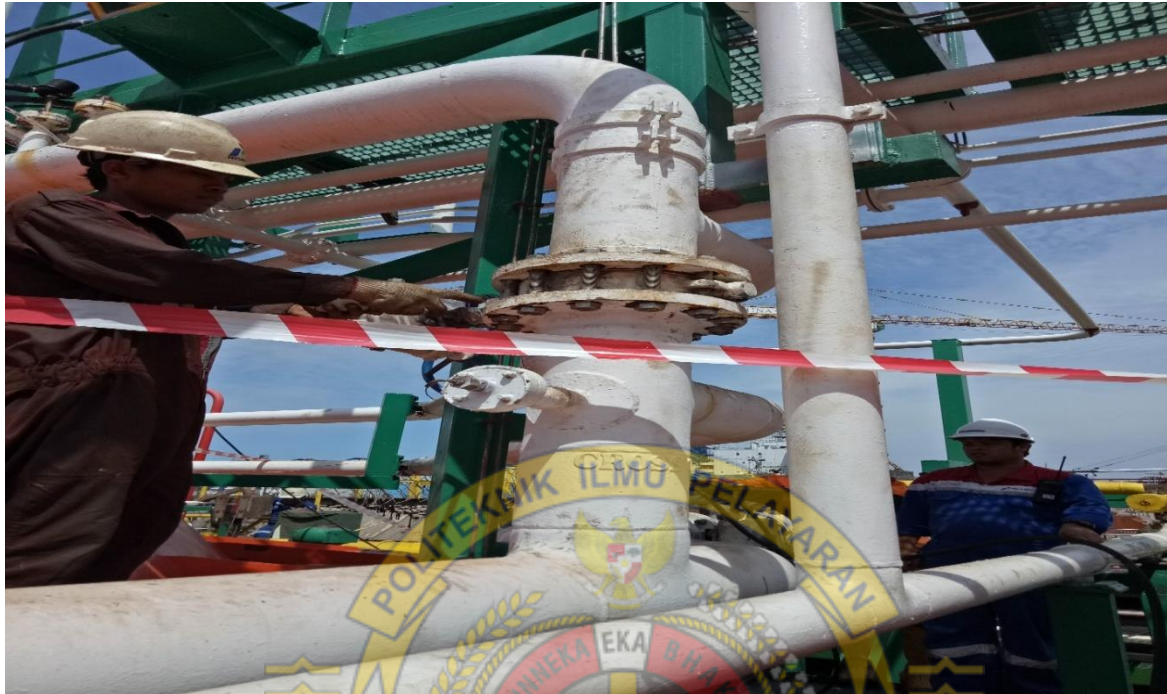
GAMBAR KONDISI PENGENCANGAN BOUT DI SEKITAR MANIFOLD
