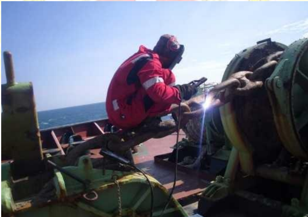
Gambar 4.2 Pelanggaran crew kapal tidak memakai safety helmet ketika bekerja.
