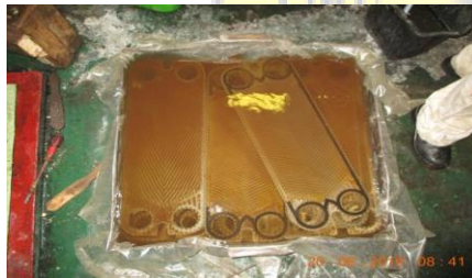
Gambar Kondisi pelat Evaporator
