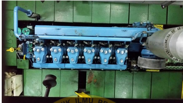
Gambar 2.2. Mesin diesel 4 tak pada MT. As Marine Satu
