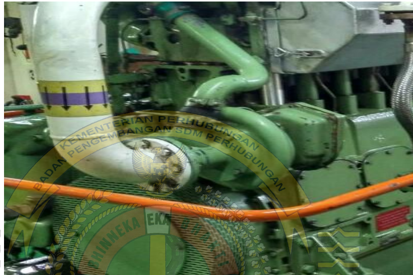
Gambar 2.6 pompa pendingin generator no 1
