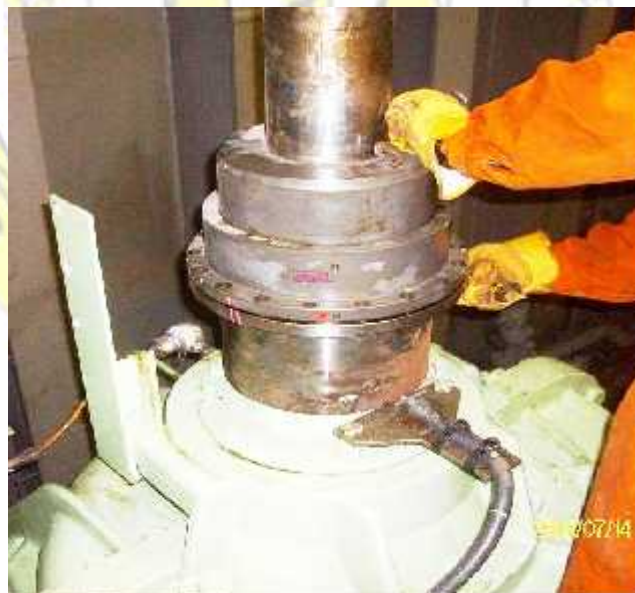
Foto overhaul cargo pump di pump room Sumber Data: Dokumentasi MT. SC OCEAN LI
