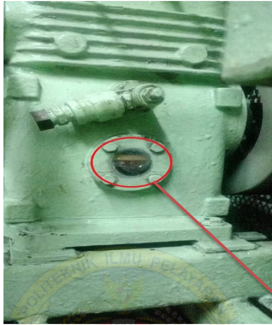
Gelas duga pada compressor
