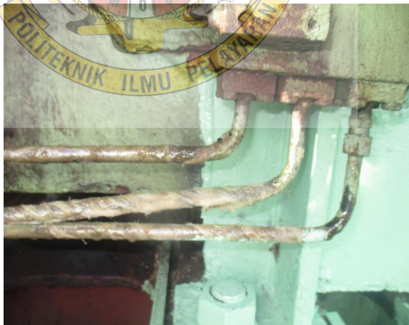
Gambar 4.7 Kebocoran pipa hidrolik pada winch
