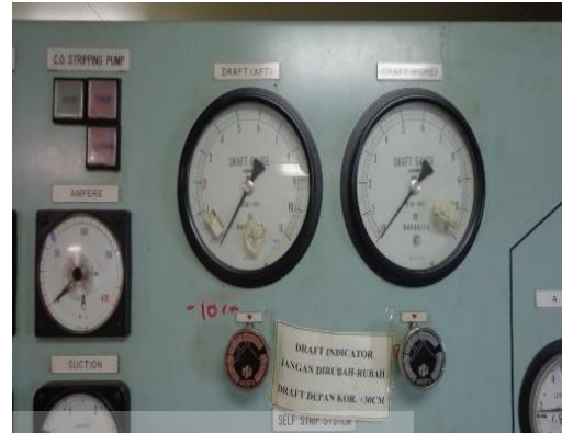
Gambar 10 : Draft Indicator rusak
