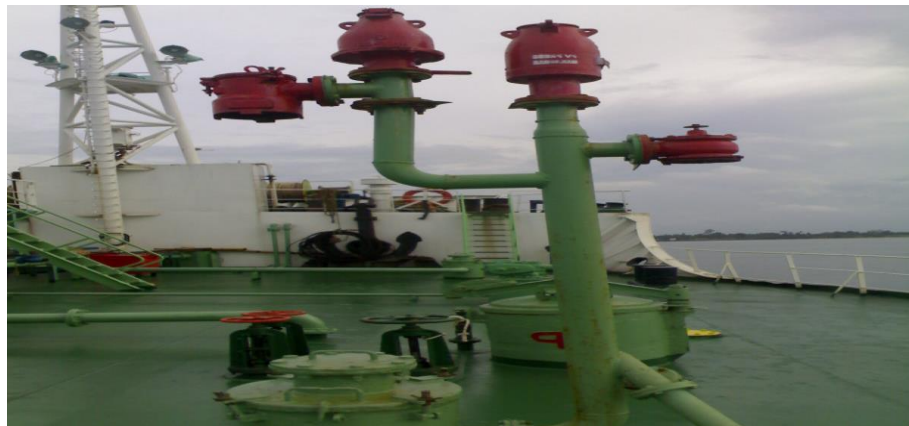
Gambar 4.3 PV Valve yang tidak standar
