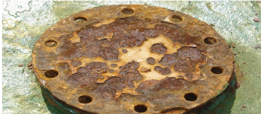
Gambar 4.5 Deck Seal COT tidak layak pakai
