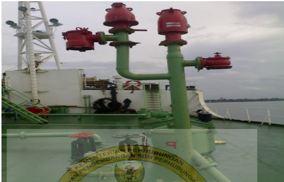
Gambar 4.3 PV Valve yang tidak standar
